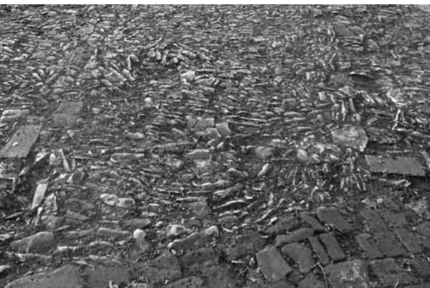
Fot. 4. Kalwaria Piekarska – odkształcenie dolnych partii kostki wapiennej (fot. Autor)
