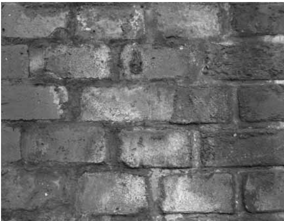
Fot. 1. Kalwaria Piekarska – zwiertzały mur ceglany (fot. Autor)
