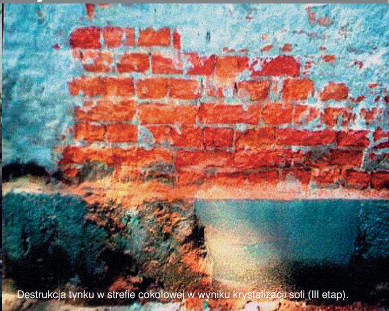
Destrukcja tynku w strefie cokolowej w wyniku krystalizacji soli (II etap).
