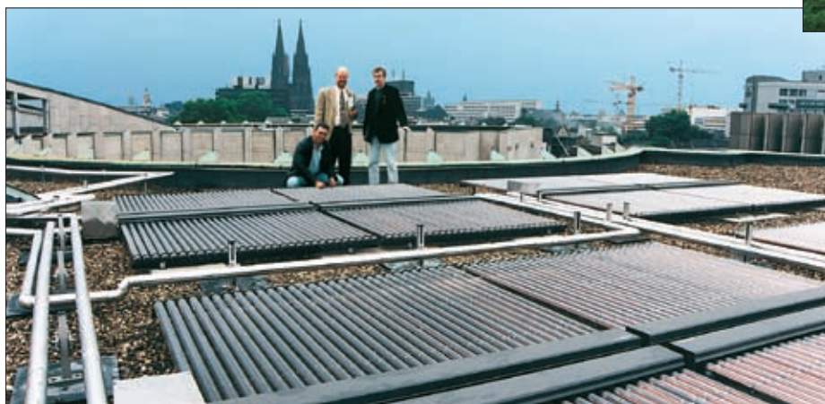
Kolektory słoneczne są coraz częściej stosowane w układach wytwarzania chłodu dla potrzeb klimatyzacji budynków biurowych
