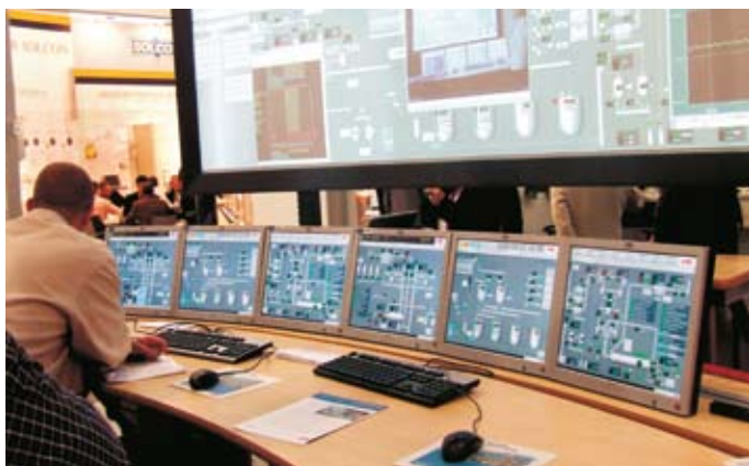
Rys. 2. Wieloekranowe stanowisko kontroli systemu automatyki
