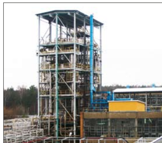
Rys. 1. Widok instalacji Produkcji Żywic Epoksydowych w Zakładach Chemicznych „Organika-Sarzyna” SA
